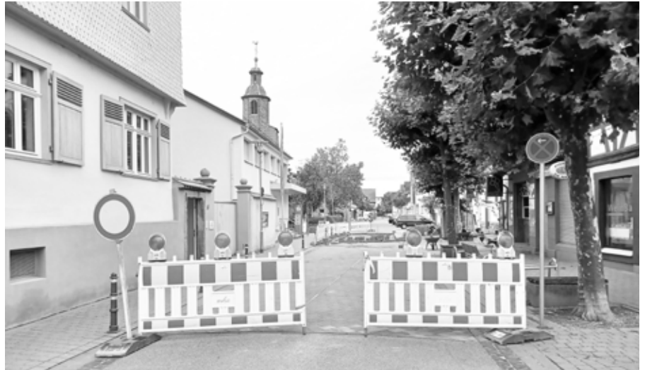
Kein Durchkommen in der Langgasse. Ausweichen auf den Gärtnerweg? Äätsch - dort ist auch eine Baustelle.
